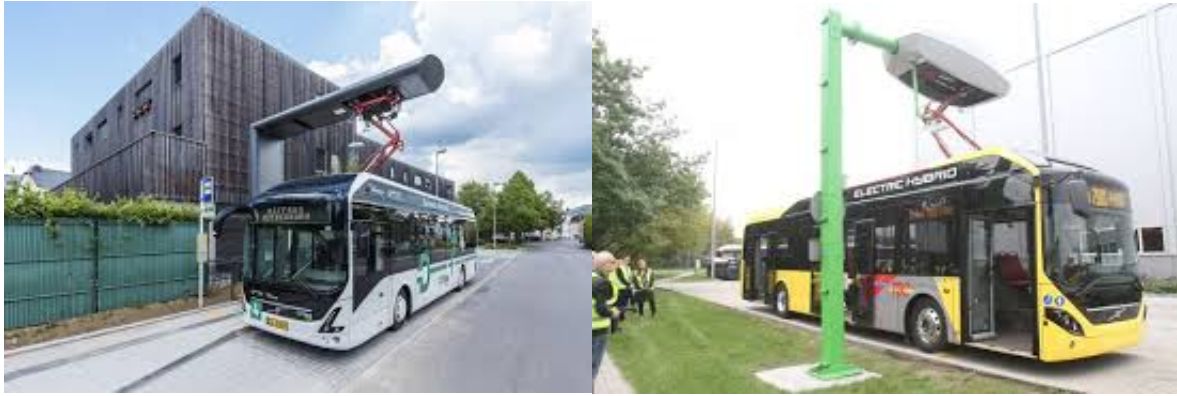
ładowanie autobusów elektrycznych poprzez pantografy
