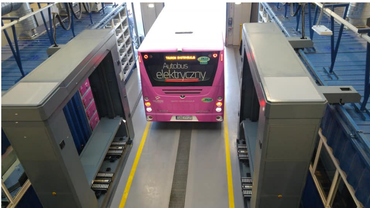
zautomatyzowana stacja wymiany akumulatorów w autobusach elektrycznych
